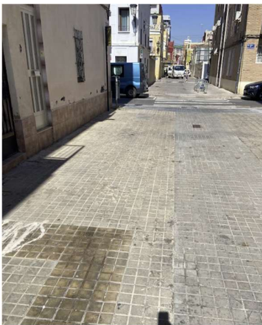
C/ La Marina, peatonal, en muy malas condiciones
